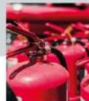
Sistemas de Incêndio
